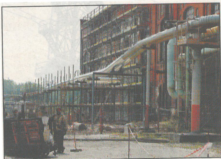
Budova bývalé kompresorovny byla napojena na objekt teplárny Suchá. Po její demolici prochází kompresorovna částečnou vnější rekonstrukcí.
