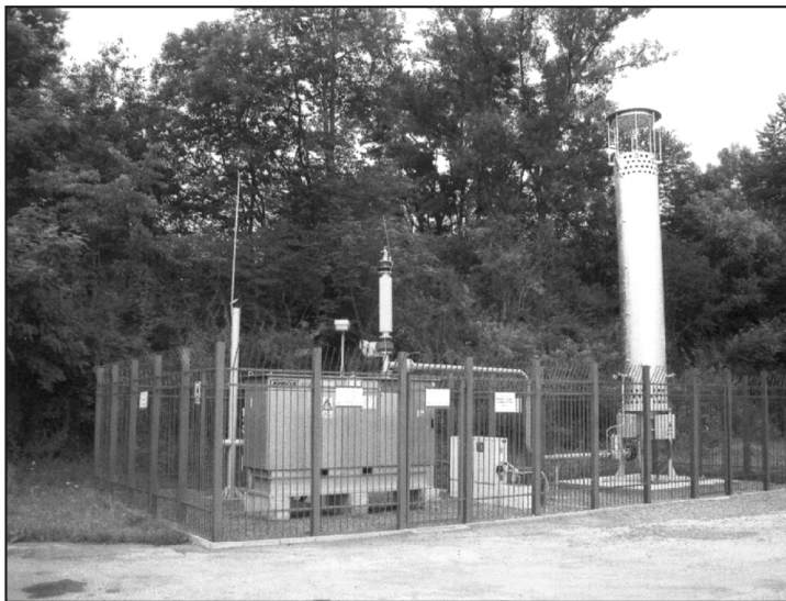
Kompresorová odsávací stanice pro zamezení výstupu důlních plynů do podpovrchových částí staveb technologických kolektorů a na povrch ve spojení se zařízením pro spalování metanovzdušné směsi s vyloučením jejího odfuku do ovzduší.
