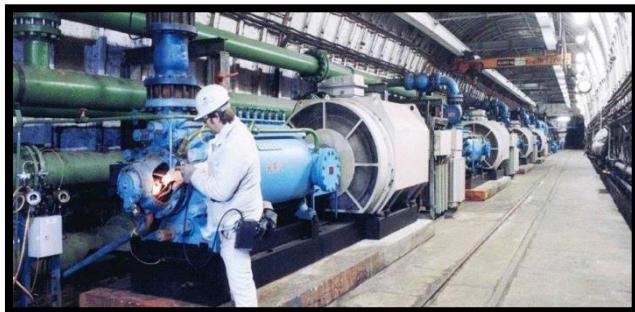
Obr. č. 2 – Čerpací stanice na 14. patře dolu Zollverein v Essenu v hloubce kolem 1 000 m (zdroj viz použitá literatura)
